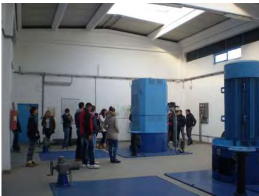
Zgrada strojarnice i položaj polovice pokretačkih motora
