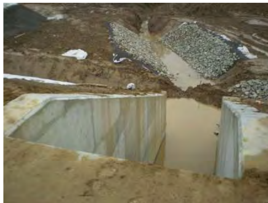
Odmaknuta izlazna građevina sa bučnicom vraća tok u korito
