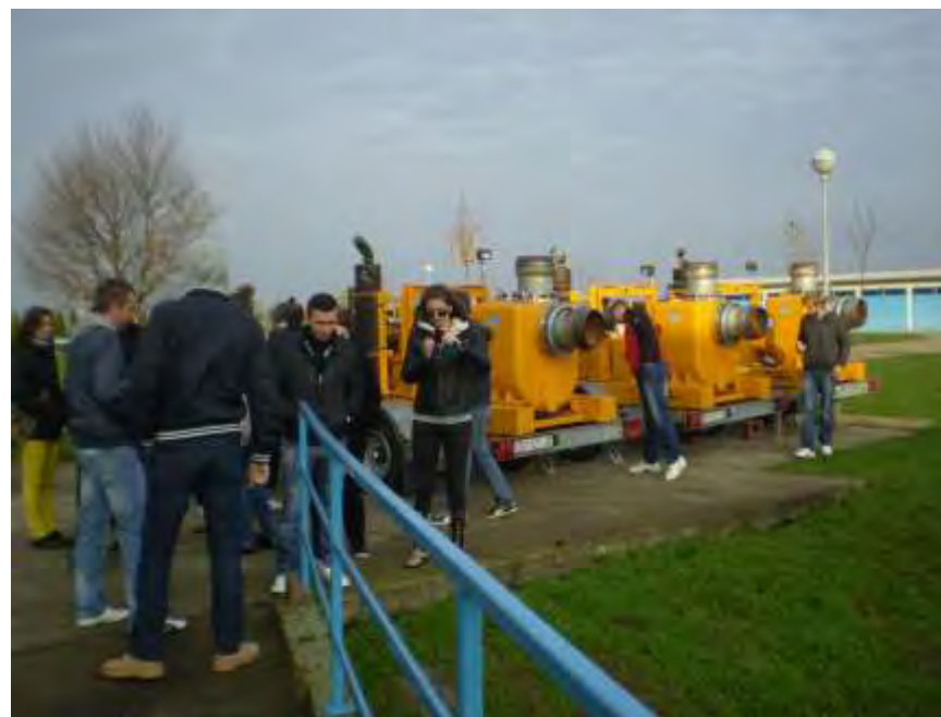
Pokretne crpne stanice i oprema unutar zaštitne ograde
