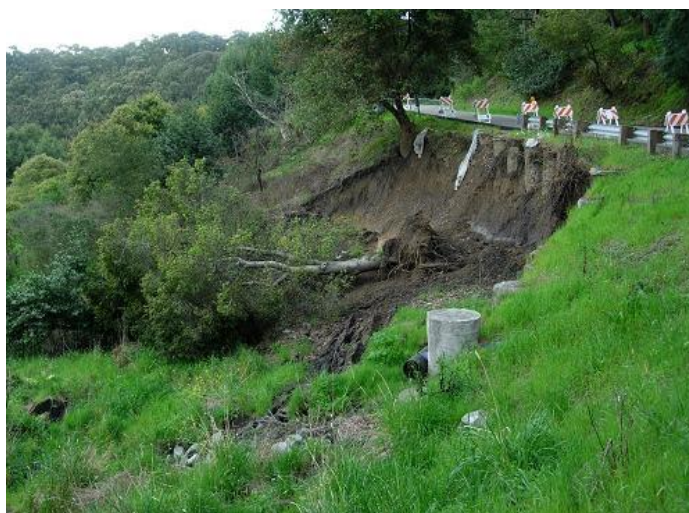
Slika 1. Tipično klizište nastalo na cesti – odron terena ceste u zasjeku
