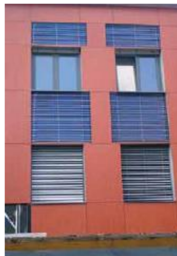
vakumski kolektori na fasadi zgrade
