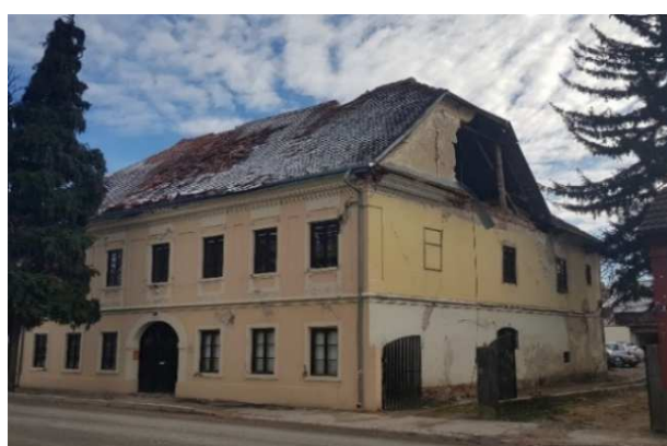
b) zgrada u Petrinji snimljena nakon potresa 28.12. 2020.
