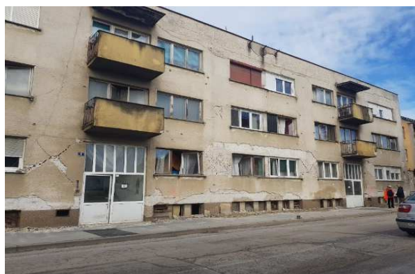
b) zgrada u Petrinji snimljena nakon potresa 28.12. 2020.
