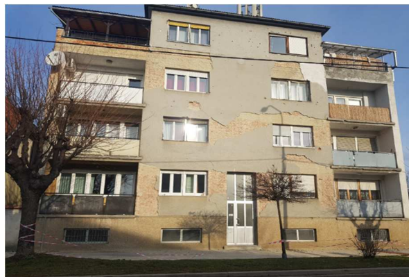
b) zgrada u Petrinji snimljena nakon potresa 28.12. 2020.
