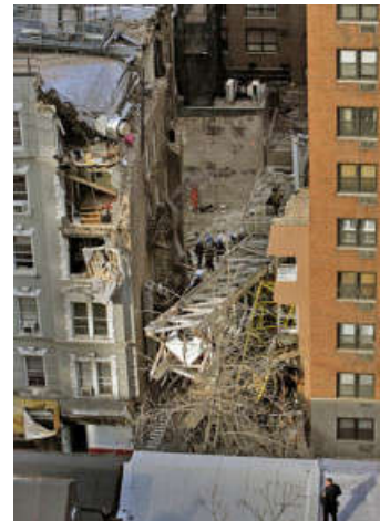
Pad kрана na stambenu zgradu u N. Yorku 2008. godine (brojne žrtve)
