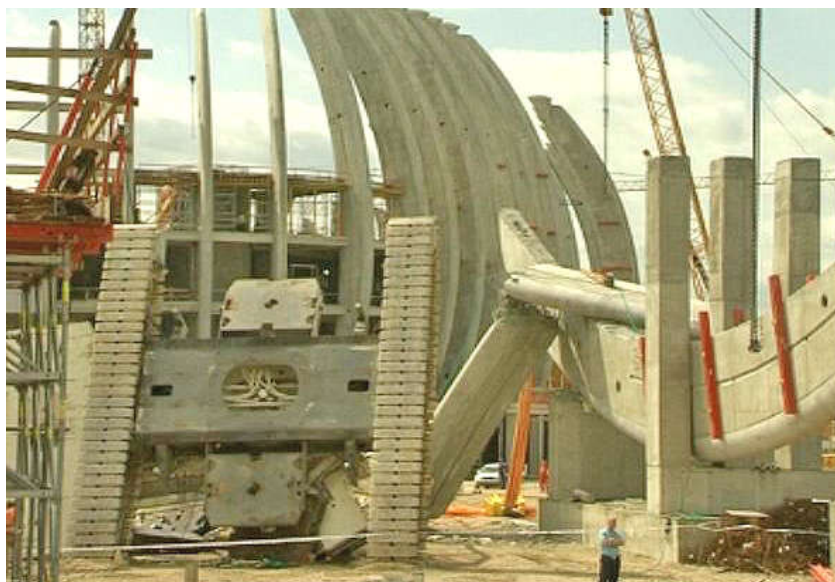
Srušena dizalica koja je postavljala montažne elemente konstrukcije sportske dvorane Arena u Zagrebu 2008. godine
