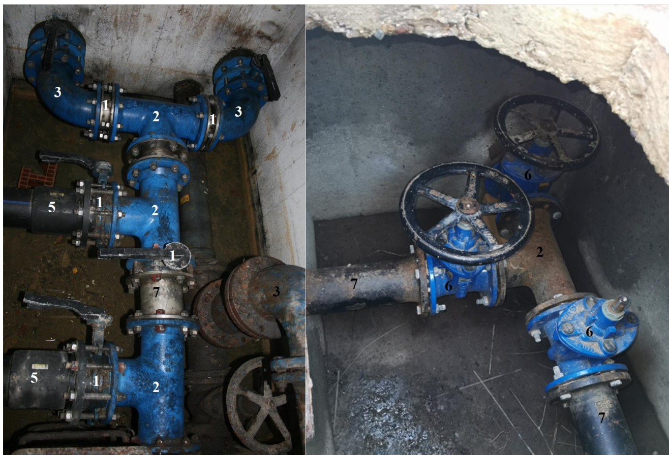
Slika 6.13 Primjer vodovodnih čvorišta
