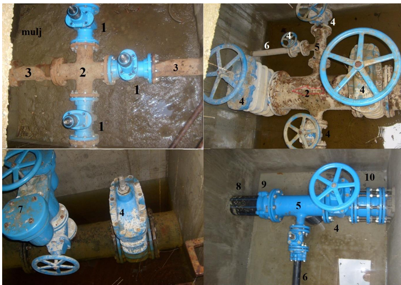
Slika 6.15 Primjer vodovodnih čvorišta
