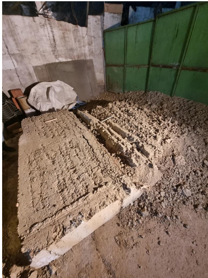
Slika 3.8 Zid W-40 nakon rušenja
