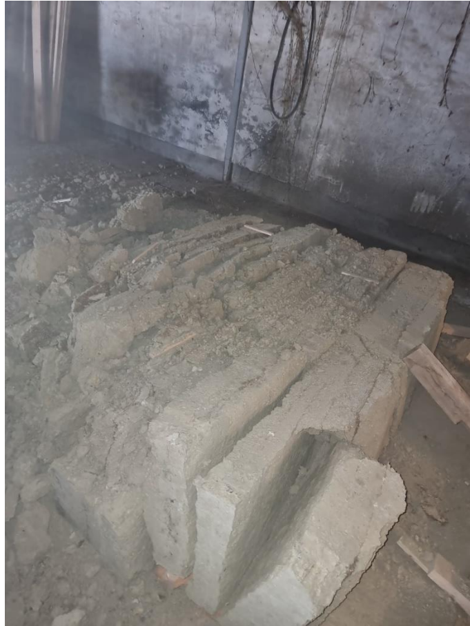
Slika 3.9 Zid W-50 nakon rušenja
