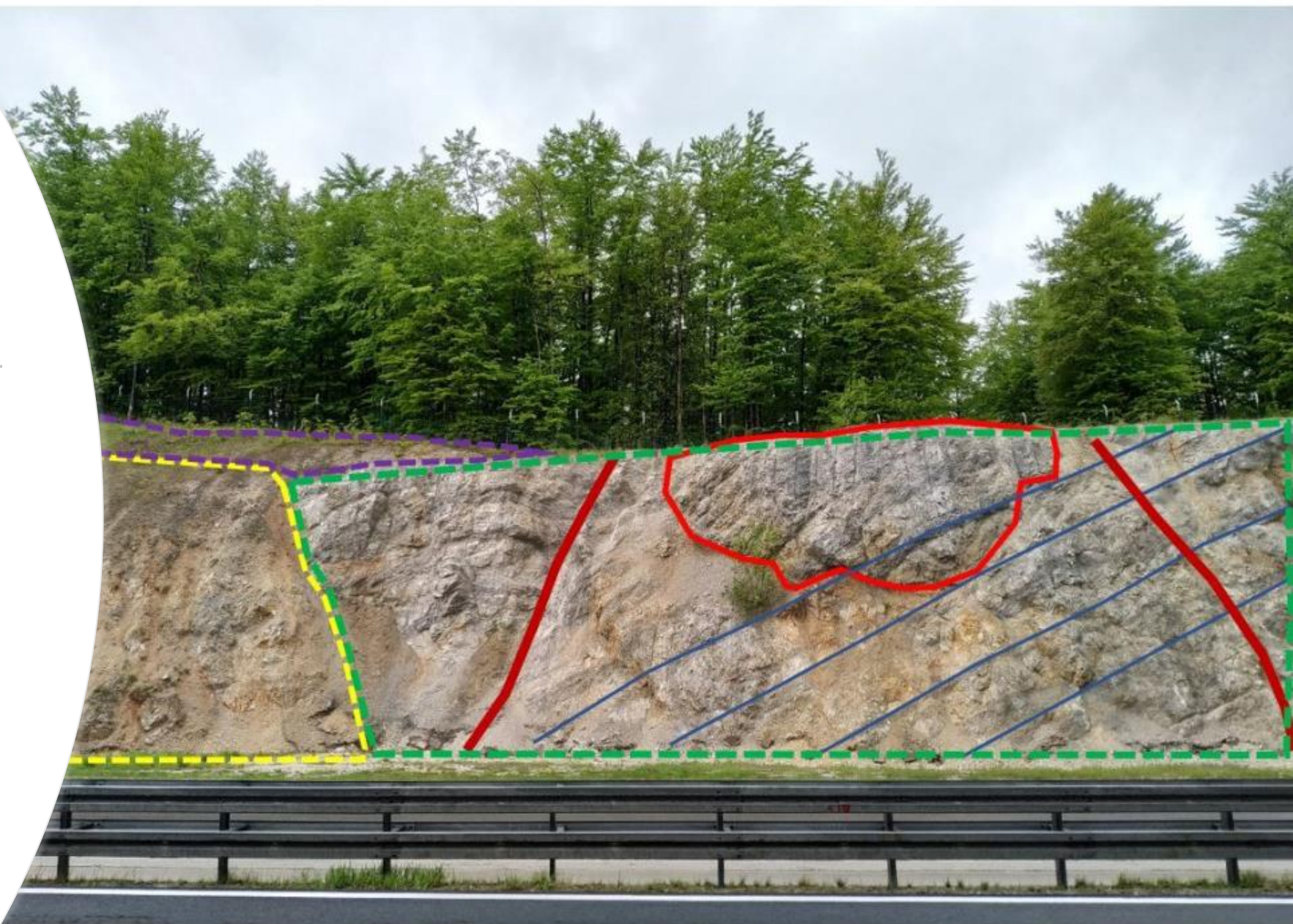
Slika 6. Prikaz kosine sa označenim elementima IG kartiranja: jako trošna stijena (žuta boja), srednje trošna stijena (zelena boja), pokrivač (ljubičasta boja), slojevitost (plava boja), pukotine (tamno crvena boja), blok u prevjesu (svijetlo crvena boja)
