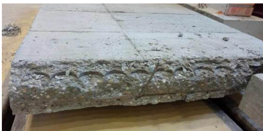
Slika 4.38: Oštećenje plošnog nosača P-P-3 tijekom opterećenja
