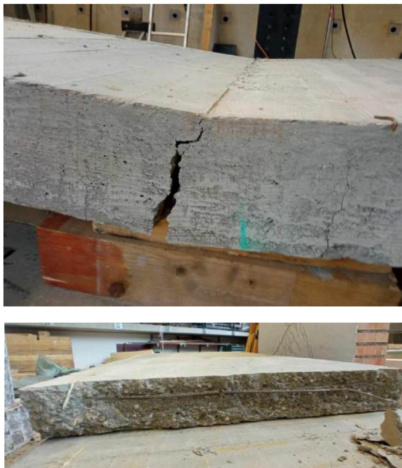
Slika 4.48: Oštećenje plošnog nosača P-K-2 tijekom opterećenja
